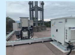
水素燃料電池を使った基地局の実証実験設備
