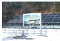
再生可能エネルギー活用通信局舎 (函館 戸井ビル)
