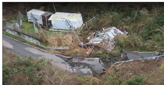
図表1-5-21 ▶ 能登半島地震による通信設備の損傷
